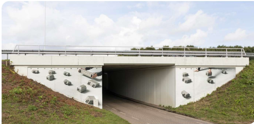
Figuur 9 Afbeelding op viaduct bij Vechten (bron: eigen foto)
